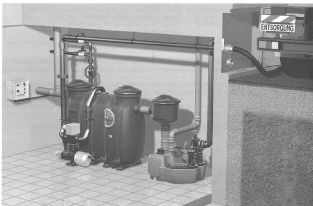
Bild 54 Abscheideranlage für Fette mit anschließender geschlossener Abwasserhebeanlage und Entsorgungsleitung für die Schlammabfuhr. Werkbild: Kessel, Lenting
