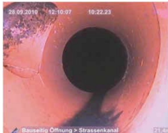
Bild 238 Riss im Anschluss BAH D, Schadensklasse B
