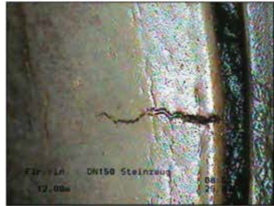
Bild 209 Brandriss BAB A + Bemerkung Schadensklasse C
