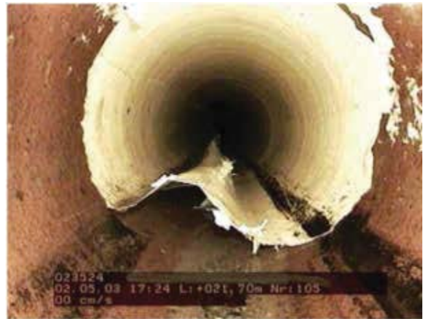
Bild 243 abgelöster Kurzschlauch, dieser Schaden kann nicht akzeptiert werden.
