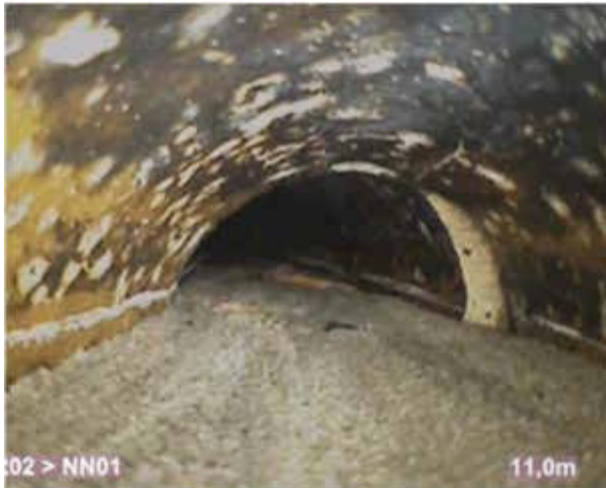
Bild 224 Feines, abgelagertes sandiges Material, BBC A 50 %, Schadensklasse A
