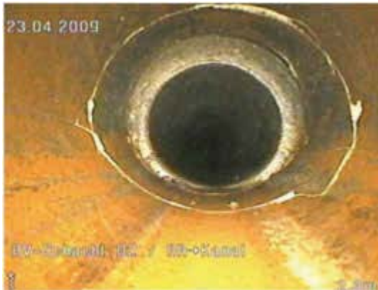
Bild 211 Riss mit Scherbenbildung an einer Rohrverbindung, BAB B C 1,0 mm, Schadensklasse B
