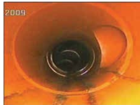
Bild 215 Verformtes Kunststoffrohr, BAA A 8 %, Schadensklasse C
