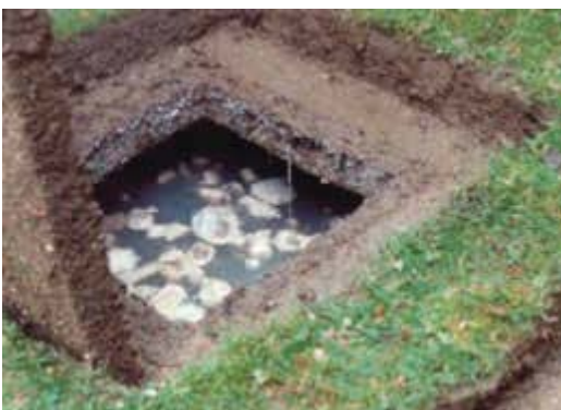
Bild 51 Kleinkläranlage in unzureichendem Zustand Werkbild: Dr.-Ing. U. Otto, Viersen
