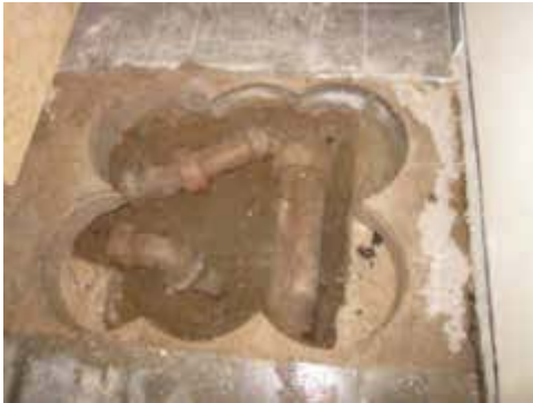
Bild 30 Mit Kernbohrer aufgesägter Kellerfußboden, um Risse im Kellerboden, hier Souterrain, zu vermeiden. Die rechte Leitung und der linke untere Abzweig wurden entfernt. Der obere Abzweig dient nur noch der Regenwasserableitung zur Regenwasserhebeanlage. Quelle: Franz Fischer Ingenieurbüro GmbH
