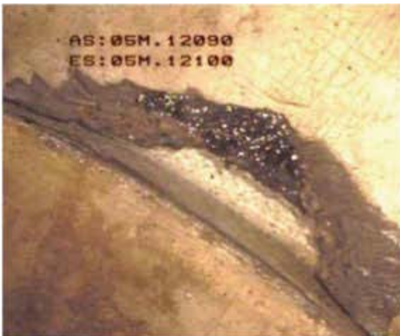
Bild 204 Abplatzung an einer Betonrohrverbindung BAF B C, Schadensklasse C
