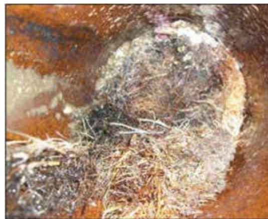
Bild 218 Komplexes Wurzelwerk, BBA C 100 %, Schadensklasse A
