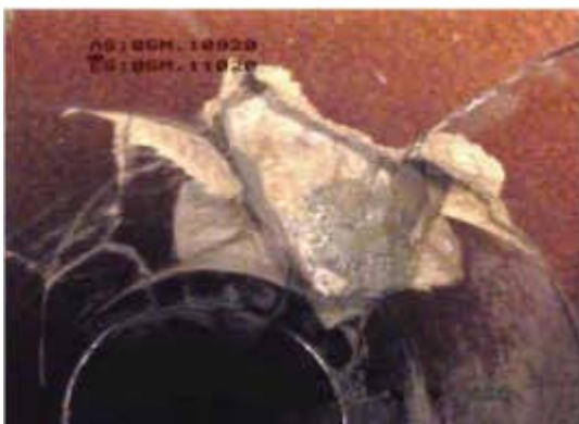
Bild 171 Eindringendes Bodenmaterial (BBD), Stein, Schadensklasse A
