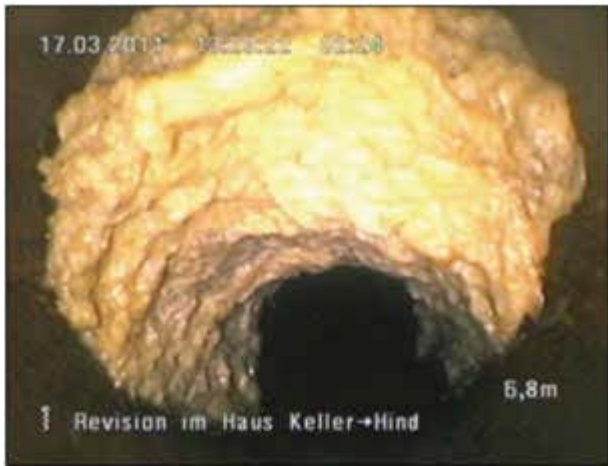
Bild 221 Anhaftungen, Fett, 70 % Querschnittsreduzierung, BBB B 70 % Schadensklasse A
