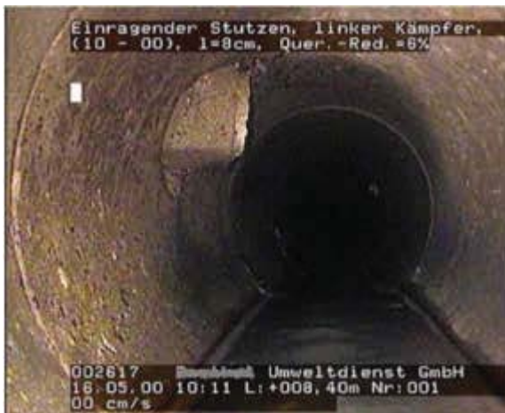
Bild 235 Tangentialer Anschluss (+ einragend, BAG), BAH A, Schadensklasse C
