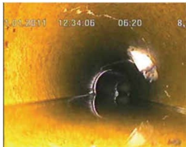
Bild 226 Wasserstand in einem Unterbogen, klar BDD A 20 %, Schadensklasse C
