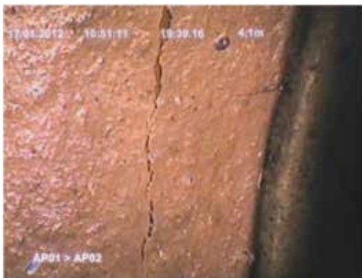
Bild 54 Brandriss in einem Steinzeugrohr
