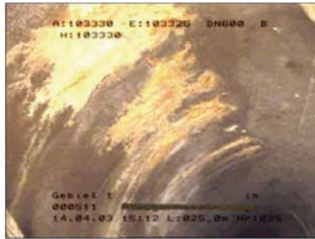
Bild 222 Kalkausfällungen, Versinterungen, BBB A 1 % (Lage 09 12), Schadensklasse C
