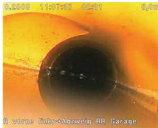
Bild 225 Wasserstand in einem Unterbogen, trüb BDD A 50 %, Schadensklasse B
