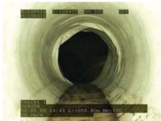
Bild 244 Faltenbildung in einem Schlauch-Liner, die nicht als renovierte Leitung akzeptiert werden sollten.
