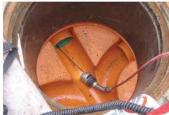
Bild 114 Einschieben der Inspektionskamera IBAK ORION L „Kieler Stäbchen“ über einen Inspektionsschacht gegen Fließrichtung in die Grundleitung Foto: Stadtentwässerung Braunschweig GmbH
