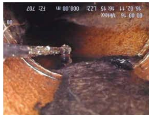
Bild 58 An der Rohrverbindung eingelaufene und einragende Teerdichtmasse
