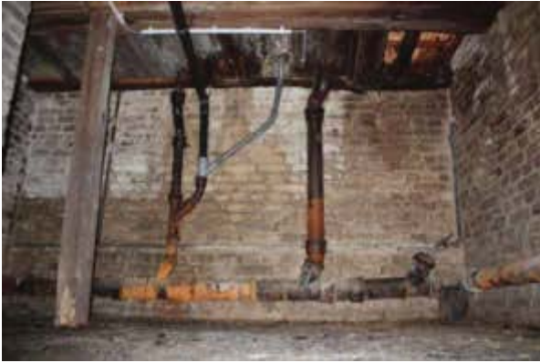
Bild 43 Erneuerung der Fall- und Sammelleitung erforderlich im Rahmen der Gebäudesanierung
