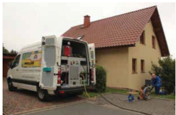
Bild 109 MU-Checkmaster CHM 8 HPK Behältervolumen: 800 l Pumpenleistung: 160 bar/80 l/min, mit: Schiebekamera: Rausch, Typ Delta-pro Werkbild: MÜLLER Umwelttechnik GmbH & Co. KG
