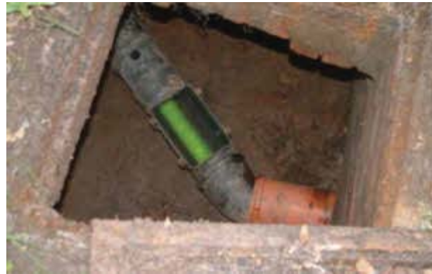
Bild 153 Fließversuch mit Uranin zur Feststellung von Fehlanschlüssen
