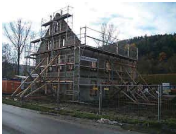
Bild 38 Totalentkernung bis auf die Grundmauern Foto: Fa. Eckert Erdbau und Industrieabbruch GmbH, Lauda-Königshofen
