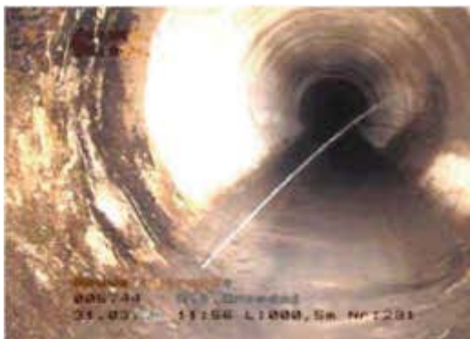
Bild 175 An einem Riss an der Rohrverbindung unter Druck einspritzendes Wasser, BBF D, Schadensklasse A
