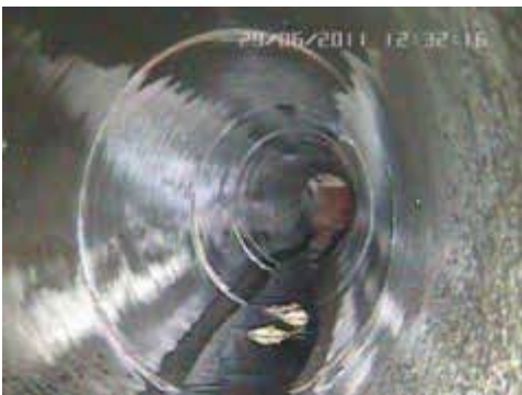
Bild 25 oben: Schachtinspektionskamera wie Bild 24 unten: Blick in die Rohrleitung vom Schacht aus. Werkbilder: Fa. Messen Nord GmbH
