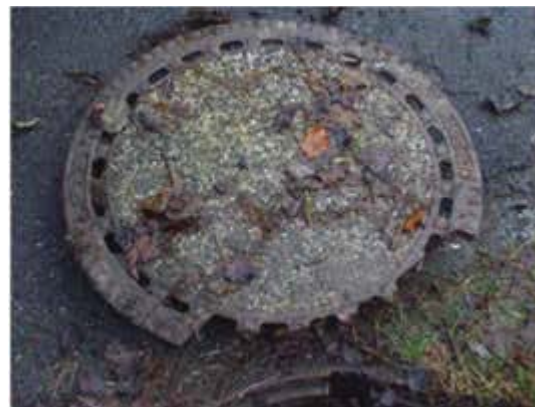
Bild 250 Schäden an der Abdeckung DAR A Schadensklasse A
