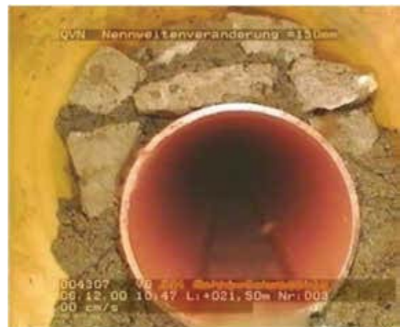
Bild 241 Nennweitenwechsel (AEC) ohne Formstück, eingemauert + BDB, Schadensklasse B
