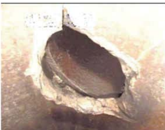
Bild 236 Zurückliegender Anschluss BAH B, Schadensklasse B
