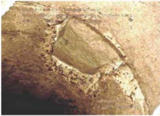
Bild 169 Stein (BAO) sichtbar, Ausbruch (BAC B) (ggf. Reparaturstelle BCB ZZ), Schadensklasse A
