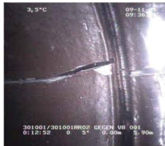
Bild 214 Längsriss, durch eine Rohrverbindung hindurch, BAB C A 5,0 mm, Schadensklasse A
