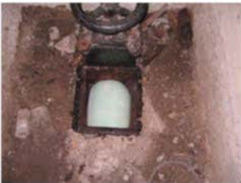
Bild 96 Mit Schlauch-Liner durchfahrener, außer Betrieb genommener Triplex (Rückstauschieber)
