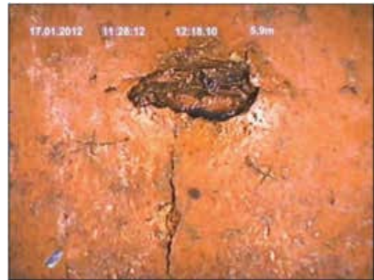
Bild 210 Brandriss und herstellungsbedingter „Lunker“, BAB A + Bemerkung Schadensklasse C
