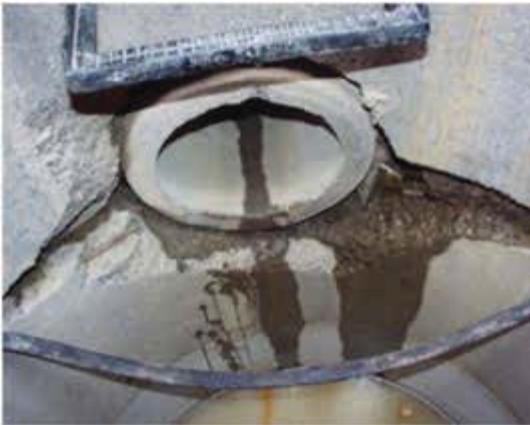
Bild 245 einragendes Dichtungsmaterial DAI A B, und DBF C, (und weitere) Schadensklasse B
