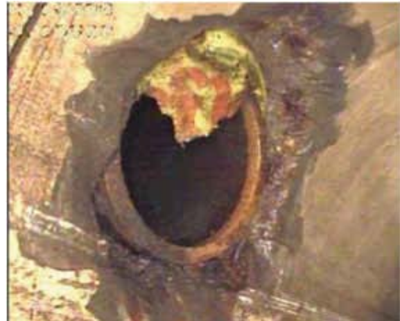
Bild 237 Unvollständig eingebundener Anschluss BAH C, Schadensklasse B
