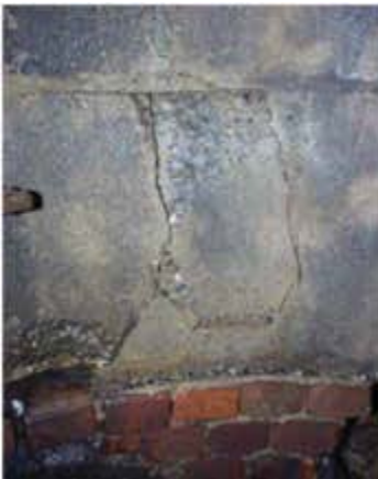
Bild 246 Rissbildung DAB B C \geq 5 mm, Schadensklasse A
