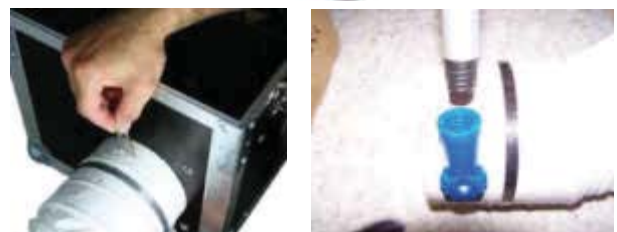
Bild 156 Kanalnebelgerät – Nebelsimulator, Nebelschlauchanschluss am Gerät (links) und Anschlussstange (rechts) zum Anschließen an das zu prüfende Leitungsnetz.
