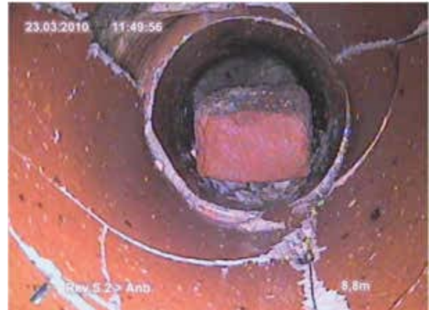
Bild 60 Provisorisch mit Ziegelstein verschlossenes Rohrende
