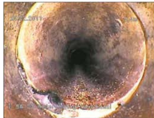
Bild 220 Einragende Dichtmasse, Teerverguss, BAI Z 3 %, Schadensklasse C
