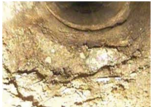
Bild 202 Fehlende Wand (unten), Korrosion durch Abwasser, BAF I D, Schadensklasse A
