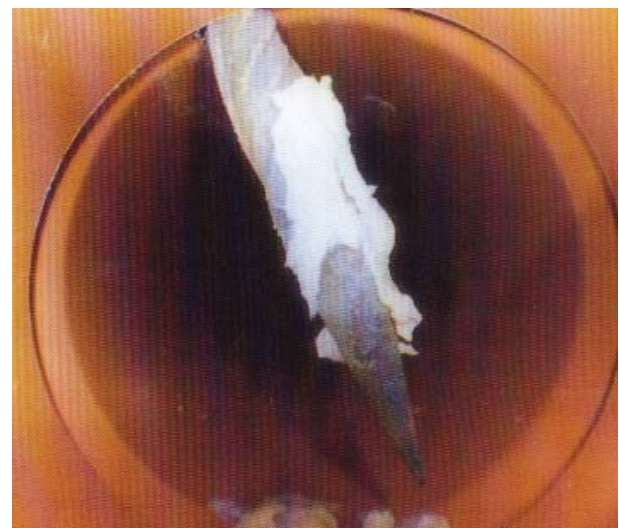
Bild 228 Hindernis, Gegenstand ragt durch Rohrwand ein, BBE D 10 %, Schadensklasse B
