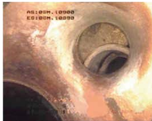
Bild 168 Boden (BAO) sichtbar an einem versetzten Zulauf (BAH Z), Schadensklasse A
