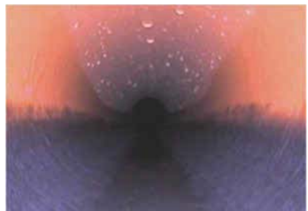
Bild 62 Schwarzfärbung der Rohrsohle eines Kunststoffrohres
