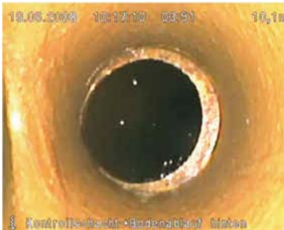
Bild 240 Lageversatz im Anschluss (Anmerkung: ca. 20 mm) BAH Z, Schadensklasse B
