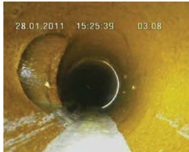
Bild 22 kein Schaden, Schadensklasse C, radiale Lageabweichung BAJ B < 15 mm (Rohrverbindung nach dem Abzweig)
