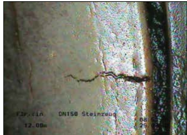
Bild 21 kein Schaden, Schadensklasse C, Haarriss BAB A (Nicht durchgehender Riss in der Glasur bei Rohr-Herstellungprozess)
