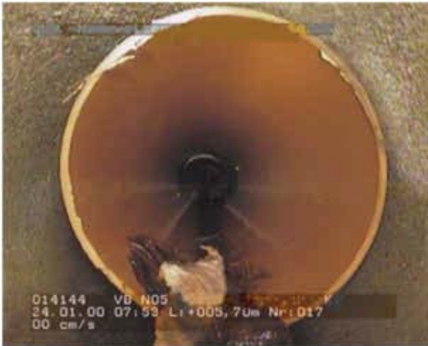
Bild 242 Nennweiten- und Materialwechsel (AEC, AED) ohne Formstück + BDB, Schadensklasse B
