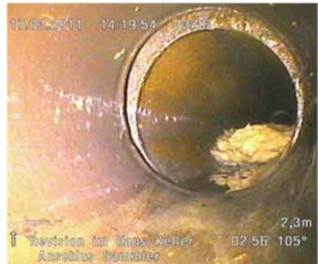
Bild 197 Radiale (BAJ B 20 mm) und winklige Lageabweichung BAJ C 7°, Schadensklasse B
