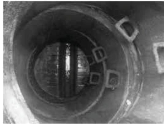
Bild 248 Verschobene Verbindung horizontal DAJ B 100 mm, Schadensklasse C insgesamt für den Schacht wegen korrodierter Steighilfen Schadensklasse A Bild: DIN EN 13508-2:2011-08, Bild G.5
