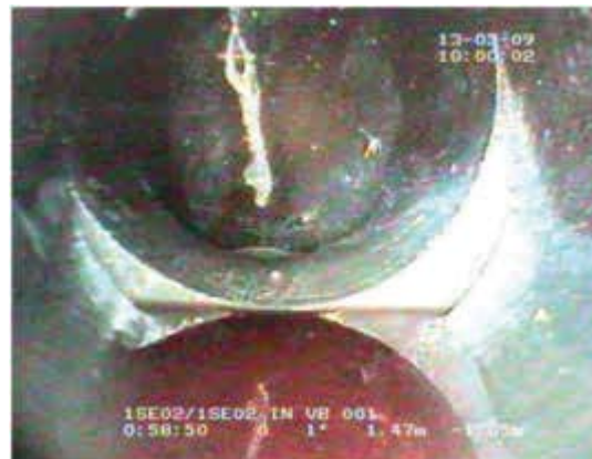
Bild 174 wie Bild 173, Wasserstand ist jedoch nach 12 Minuten abgesunken, BBG, Schadensklasse A
