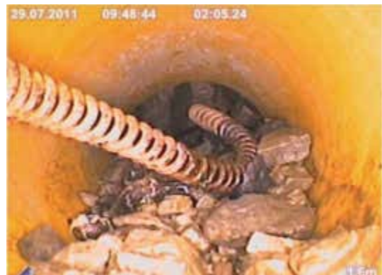
Bild 172 Eindringendes Bodenmaterial (BBD), Schotter durch offenes Rohrende, Schadensklasse A
