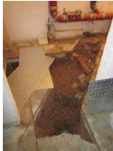
Bild 69 Außerbetriebnahme der Mischwassergrundleitungen, stattdessen Sammelleitungen in S und R getrennt Von 300 m Grundleitung wurden nur ca. 20 m für die Regenwassergrundleitung einer Kelleraußentreppe benötigt mit Anschluss an eine Hebeanlage. Foto: Franz Fischer Ingenieurbüro GmbH, Erfstadt
