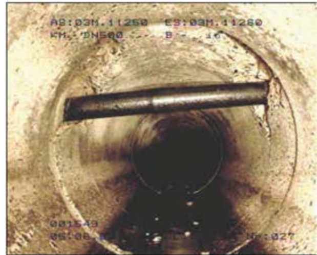
Bild 227 Hindernis, querende Leitung, BBE G 10 %, Schadensklasse A
