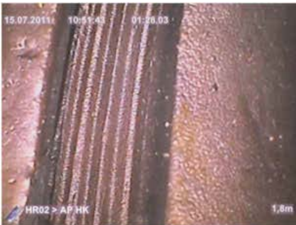
Bild 193 Axiale Lageabweichung (in Längsrichtung verschoben) BAJ A 30 mm, Schadensklasse B
