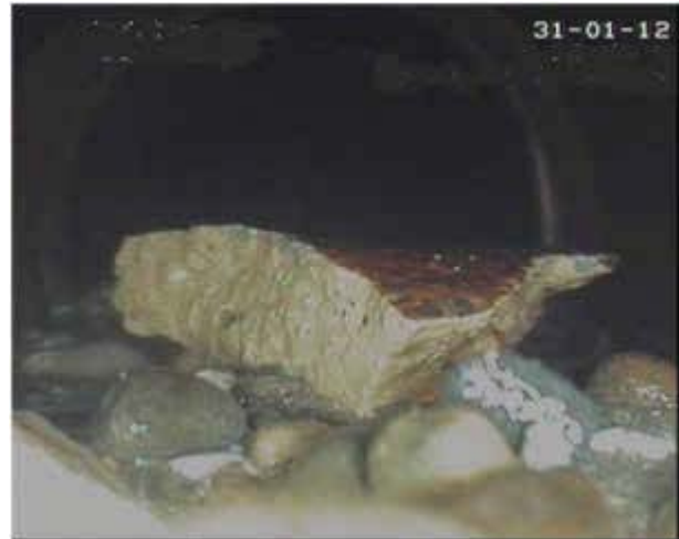
Bild 231 Hindernis, Rohrbruchstück in der Rohrsohle, BBE B 30 %, Schadensklasse A
