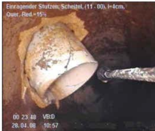
Bild 233 Einragender Anschluss BAG 25 %, Schadensklasse B
