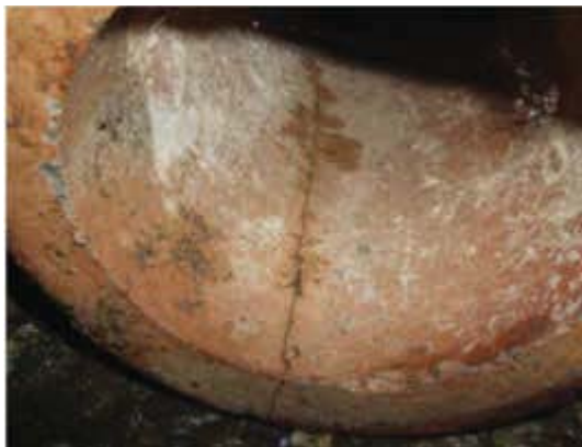
Bild 212 Längsriss an einer Rohrverbindung, BAB B A 0,5 mm, Schadensklasse C
