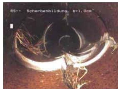
Bild 216 Verformtes STZ-Rohr, Riss- bzw. Bruchbildung, Wurzeln, BAA A 25 %, Schadensklasse A
