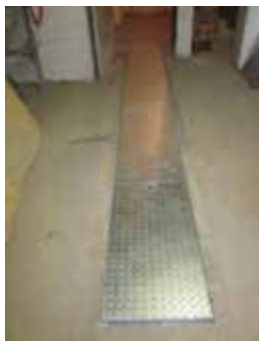
Bild 102 Zugängliche Verlegung im Rohrkanal, Edelstahl-Abdeckung
