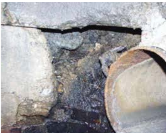
Bild 247 Boden sichtbar und Ausbruch DAO \leq 0,5 m über Rohrscheitel, Schadensklasse A DAC B 200 mm
