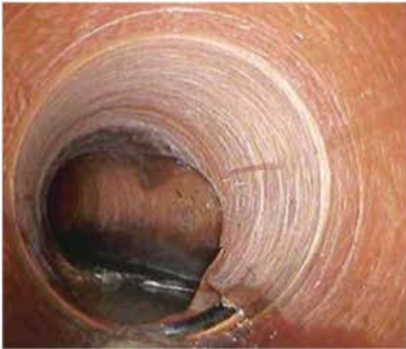
Bild 203 Mechanisch aufgerautes Kunststoffrohr BAF B C, Schadensklasse C (+ weitere Schäden)
