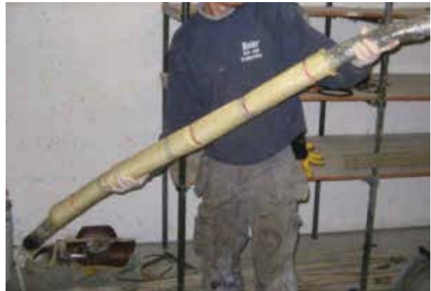
Bild 76 Für den Einbau in eine Grundleitung vorbereiteter, mit Harz getränkter ca. 2 m langer Kurzliner auf einem Packer
