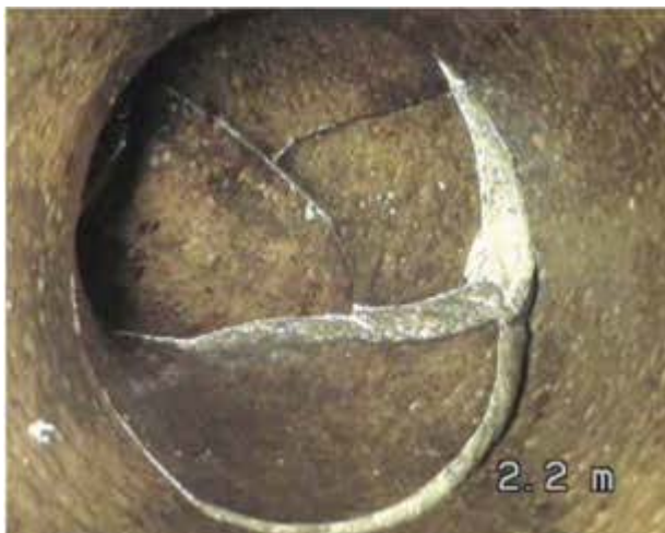
Bild 198 Bruch mit verschobenen Rohrsegmenten BAC A, Schadensklasse A
