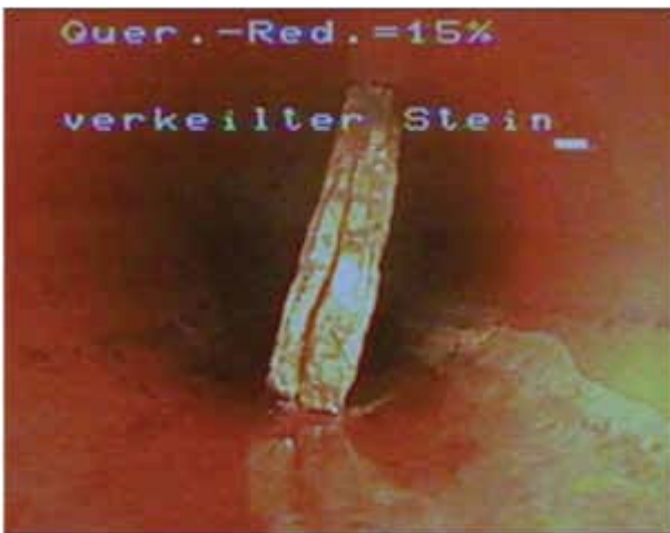
Bild 230 Hindernis, Stein im Rohr verkeilt, BBE Z 20 %, Schadensklasse B
