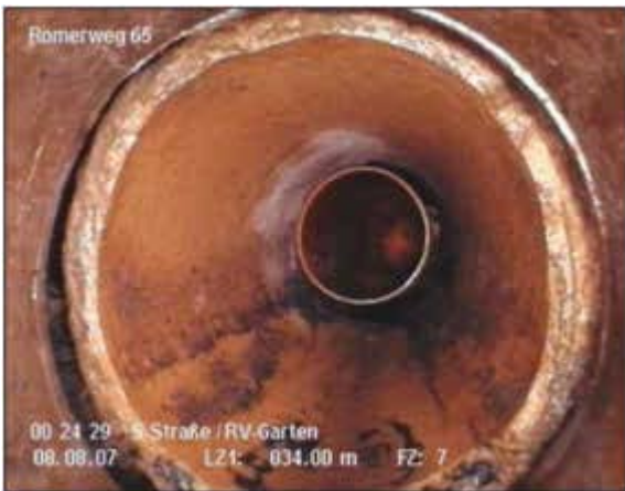
Bild 57 Mechanisch gekürztes Rohrspitzende Im Bild ist eine Rohrverbindung mit einem mechanisch gekürzten Rohrspitzende zu erkennen. Hierfür gibt es keine eigene Kodierung. Im Bedarfsfall kann man diesen Zustand mit einer allgemeinen Bemerkung (BDB) aufnehmen oder aber diese Auffälligkeit ersatzweise zur Kodierung BAJ A für axiale Lageabweichungen textlich vermerken.
