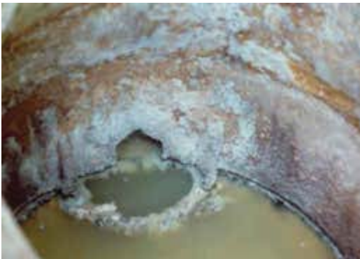
Bild 50 Kleinkläranlage in unzureichendem Zustand Werkbild: Dr.-Ing. U. Otto, Viersen
