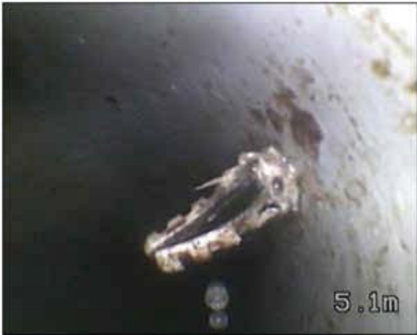
Bild 229 Hindernis, Dübel ragt durch die Rohrwand ein, BBE D 5 %, Schadensklasse B
