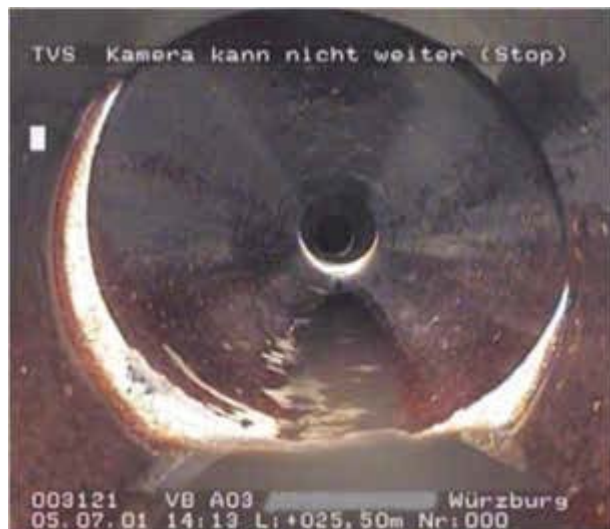
Bild 196 Radiale Lageabweichung BAJ B 20 mm, Schadensklasse B
