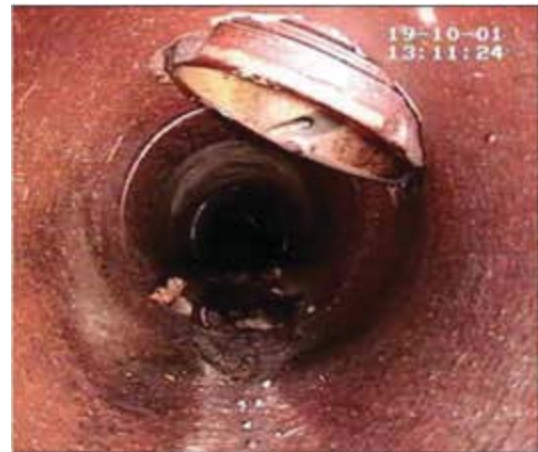
Bild 234 Einragender Anschluss BAG 15 %, Schadensklasse B
