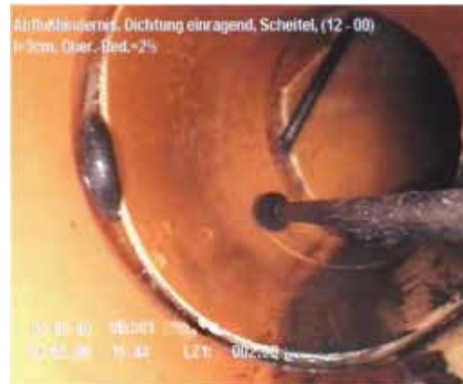
Bild 219 Einragender Dichtgummi, BAI A A, Schadensklasse B
