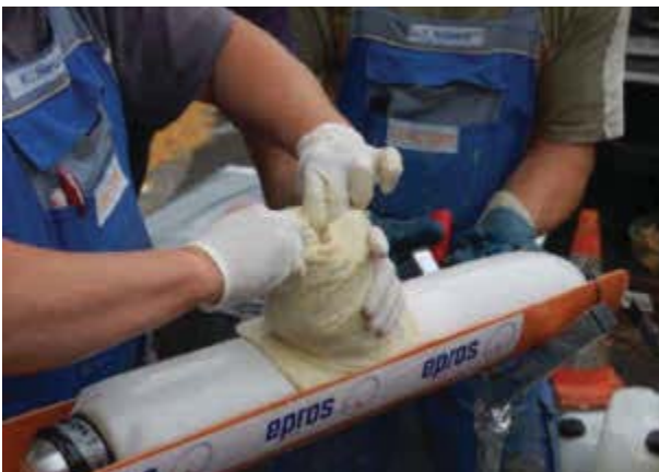
Bild 84 wie Bild 83, Vorbereitung der Reparatur durch Aufsetzen und Einkrepeln eines harzgetränkten Hutprofils in den Packer. Nach Positionieren des Packers am Anschlussstutzen der Grundleitung wird das Hütchen durch Druckluftbeaufschlagung des Packers in den Anschlussstutzen eingefahren. Fa. Trelleborg Pipe Seals Duisburg GmbH
