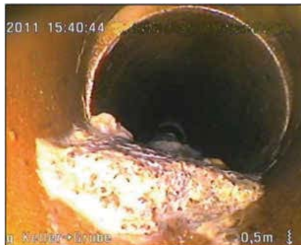
Bild 223 Verfestigte Ablagerungen, BBC C 20 %, Schadensklasse B
